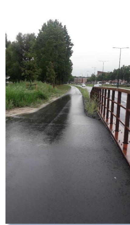
eenrichtingsbord ontbreekt, wordt mogelijk verbreed naar 2 richtingen fietspad
